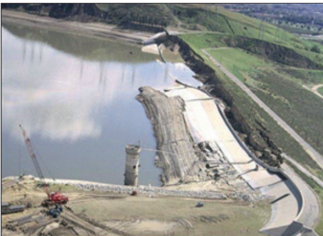
FIGURA 6 Parziale collasso della diga di San Fernando dovuto a liquefazione [2]
