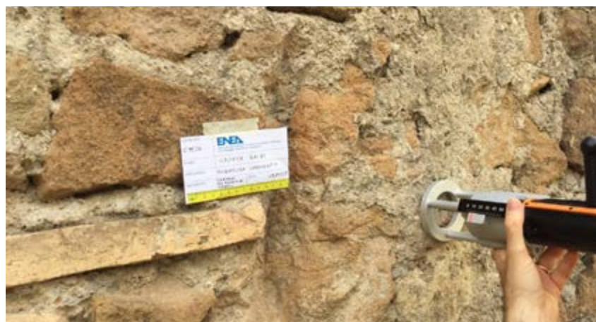
Fig. 5 Prova penetrometrica sulle malte delle murature della chiesa/convento di Santa Caterina
