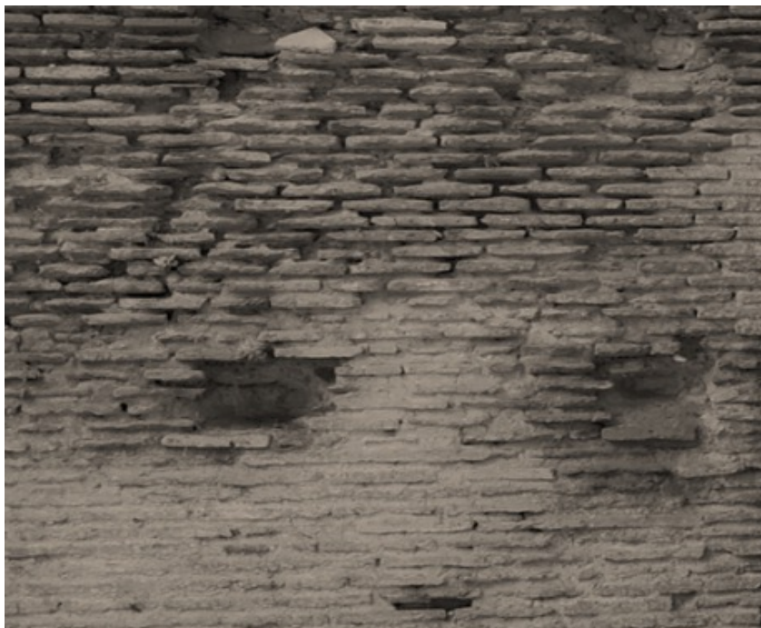
Fig. 2 Porzione di muratura interessata da umidità di risalita e conseguente attacco biologico
