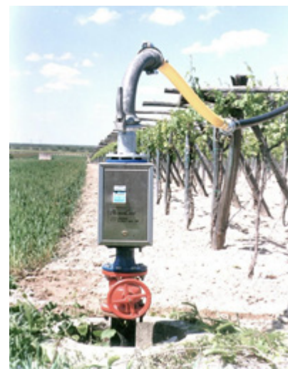
Figura 3 – Idranti automatici con schede elettroniche.
