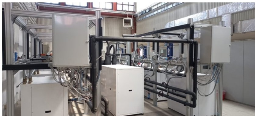
Figura 4. Rete termica a bassa temperatura presso ENEA Portici
