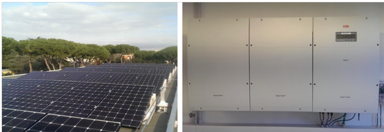
Figura 1: Il generatore fotovoltaico e il sistema d'accumulo dello Smart Building F40
