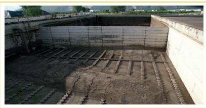
FIGURA 2 Sabbie accumulate nel comparto biologico di un depuratore a fanghi attivi
