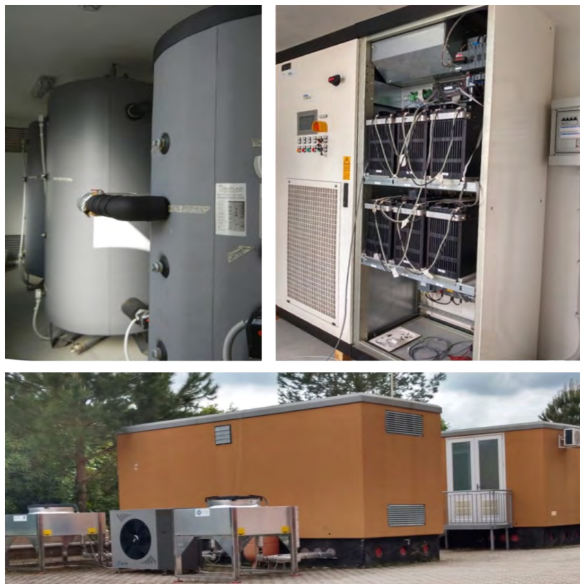
Fig. 1 Foto dell'impianto S.A.P.I.EN.T.E. presente al Centro Ricerche ENEA Casaccia
