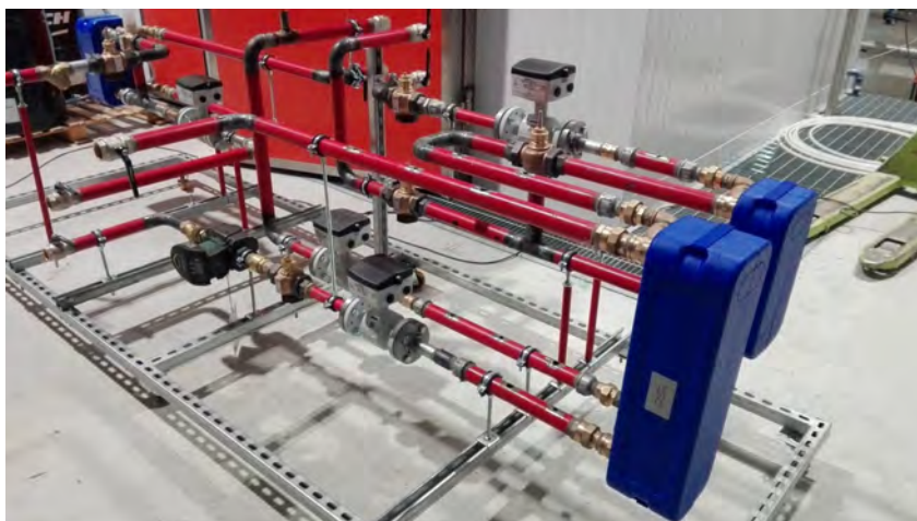
Fig. 4 Sottostazione bidirezionale di scambio termico
