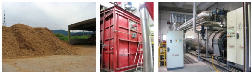
Figura 3 - Impianto di cogenerazione a biomasse di Calenzano (FI) della Biogenera S.r.l.
