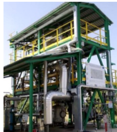
Figura 1: Impianto PRAGA (uPdRAft GASification) presso il Centro Ricerche ENEA Trisaia
