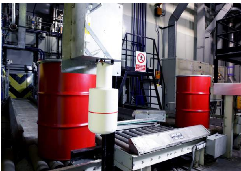
Fig. 3 Impianto di trattamento Nucleco per rifiuti solidi
