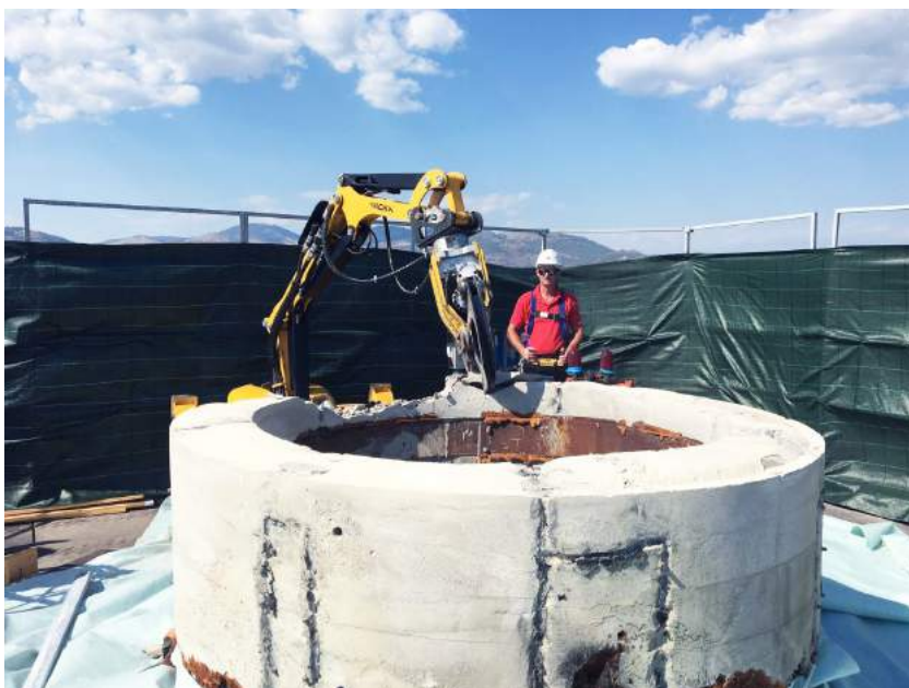
Fig. 3 L'avvio della demolizione del camino della centrale del Garigliano con la tecnica della frantumazione controllata
