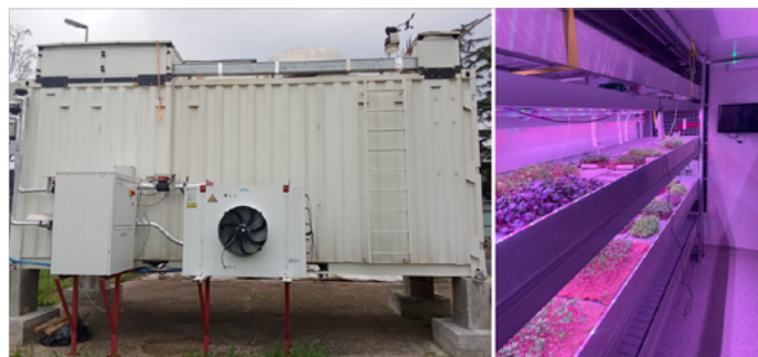
Figura 4 - Esterno container farm MICROx2 con pompa di calore ad alta temperatura (sx). Interno sistema di coltivazione automatizzata integrato di sensori IRT ed ambientali per la misurazione delle temperature ed umidità dell'aria, del substrato e della pianta (dx).
