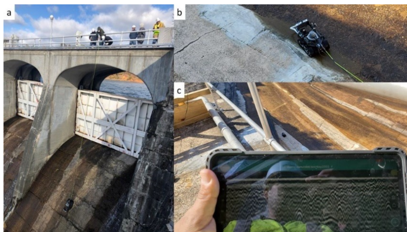
Figura 4. Robot per la manutenzione di impianti idroelettrici
